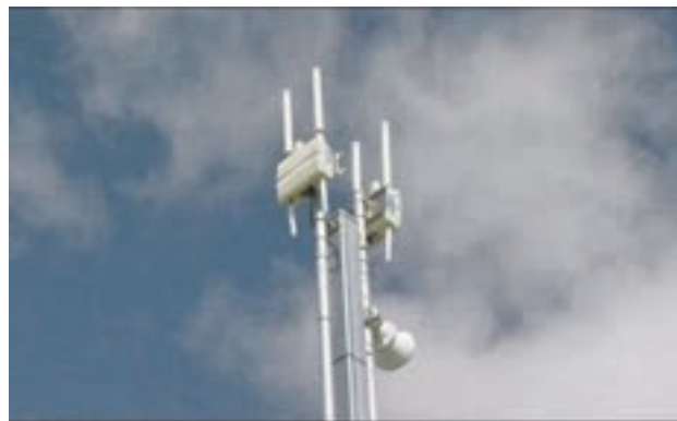
図5 通信ポール（送受信機）（HP 動画より）
