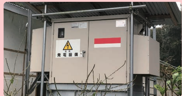
非常用電源の確保
