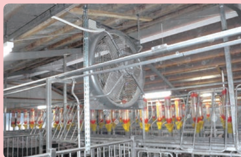
豚舎内に設置された流動ファン
